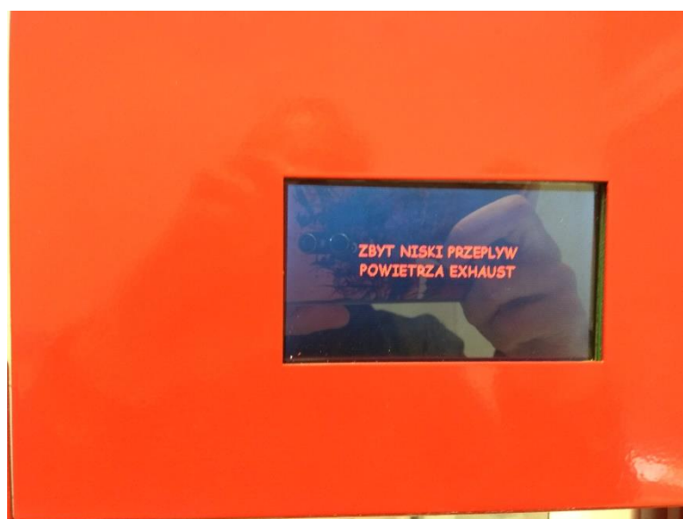
Fot. 4 Monit alarmujący o zaburzeniu przepływu powietrza
